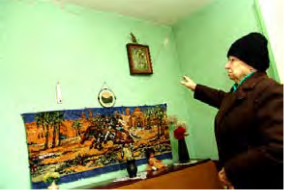
Doamna Secreta Florescu ne arată neputincioasă fisurile peretelui
