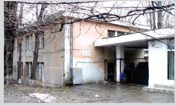
Dispensarul din strada Saturn se tasează, iar acoperișul său este... permeabil
