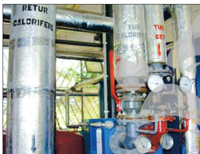
Când toate punctele termice vor arăta așa, nu vom mai avea probleme la repornirea sistemului.
