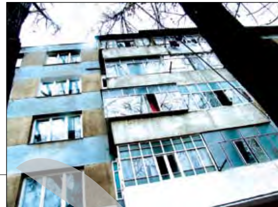
Blocul afectat de explozie
