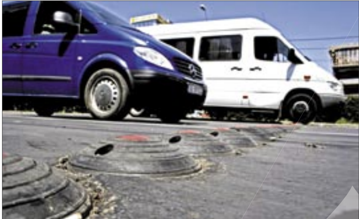
Și în oraș dispozitivele de reducerea vitezei s-au afundat în asfalt
