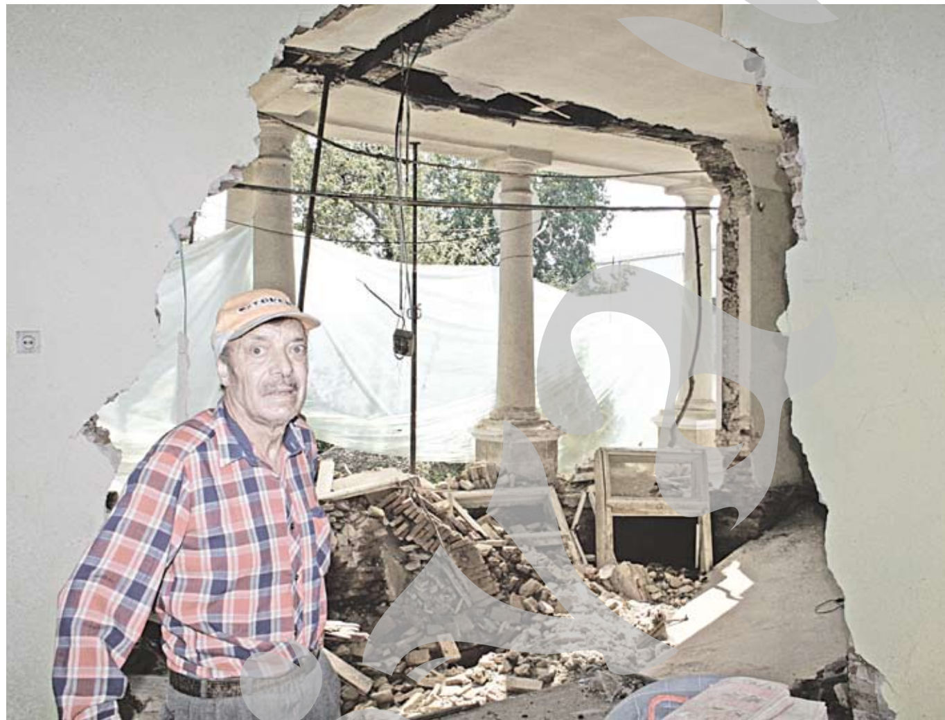
Așa arată clădirea monument istoric de pe strada Galați nr. 7. Vina aparține inundațiilor din toamna anului trecut
