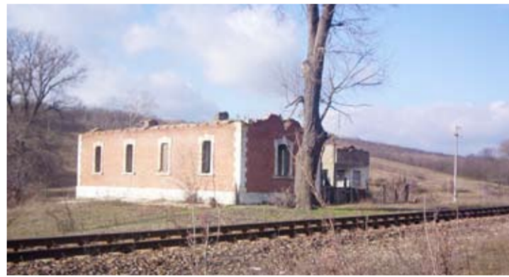
Cantonul CFR de la Băneasa. Cu acoperișul „evaporat”, arată de ce au fost în stare să facă răii-răilor din această comună
