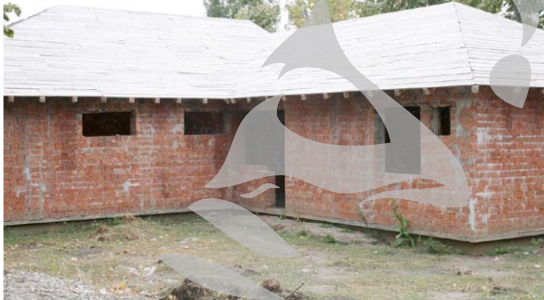
Construcția de la Brăhășești s-ar putea ruina dacă nu se primesc bani
