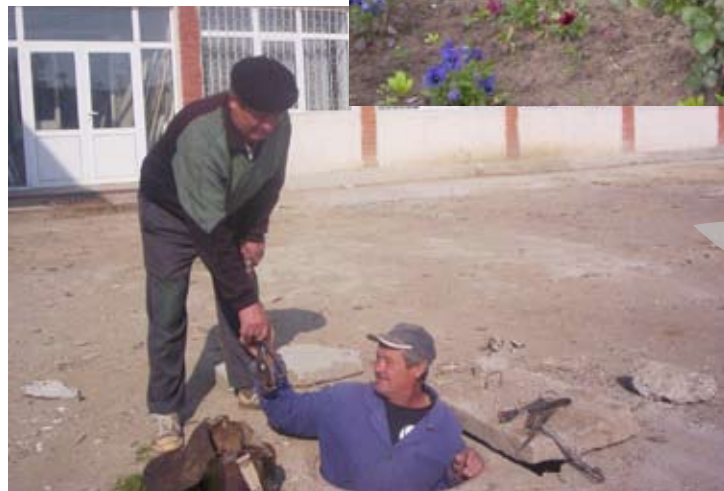
Intrat într-o gură de canal, Costică Mirceaș. Deasupra, Anton Donose. Starea de uzură înaintată a rețelei de apă le-a stricat multe duminici și zile libere. Nu termina de remediat o defecțiune că imediat apare alta...
