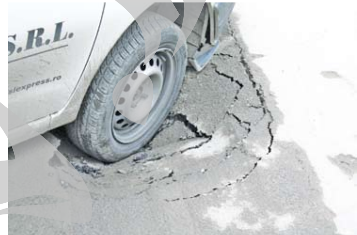
Asfaltul a cedat sub greutatea mașinii
