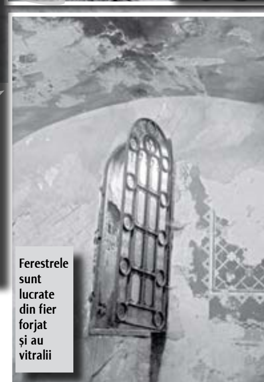
Interiorul cavoului este superb, dar este degradat
