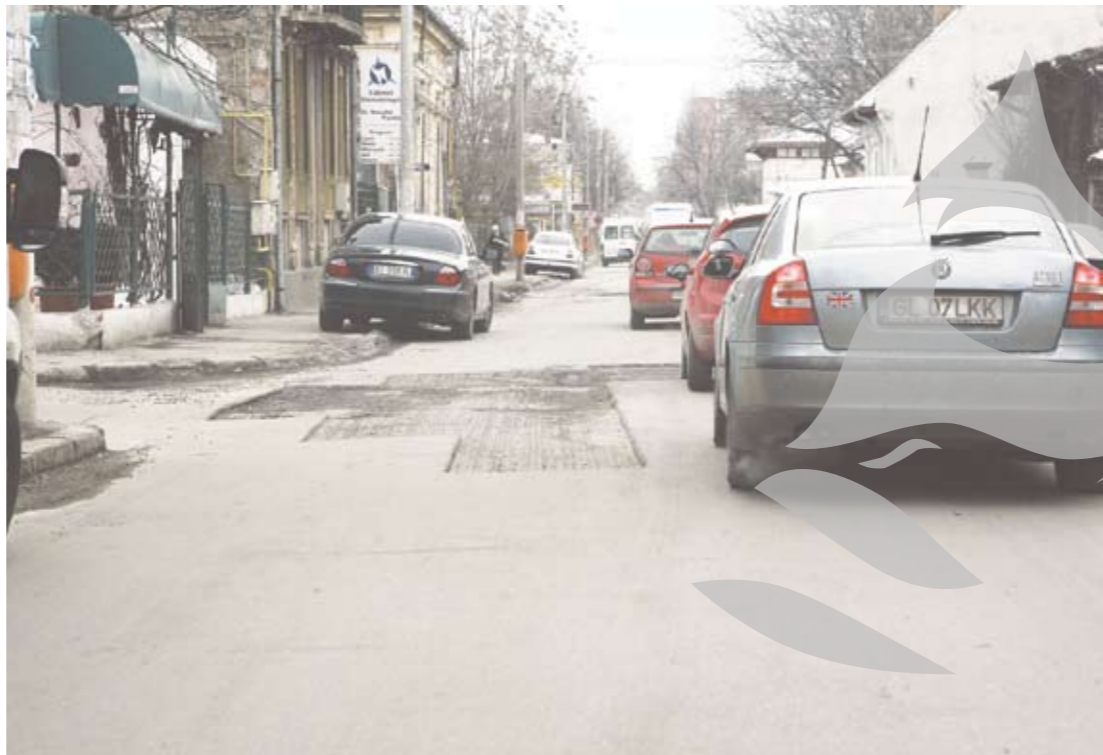
Străzile s-au transformat peste noapte în șanțuri din asfalt
