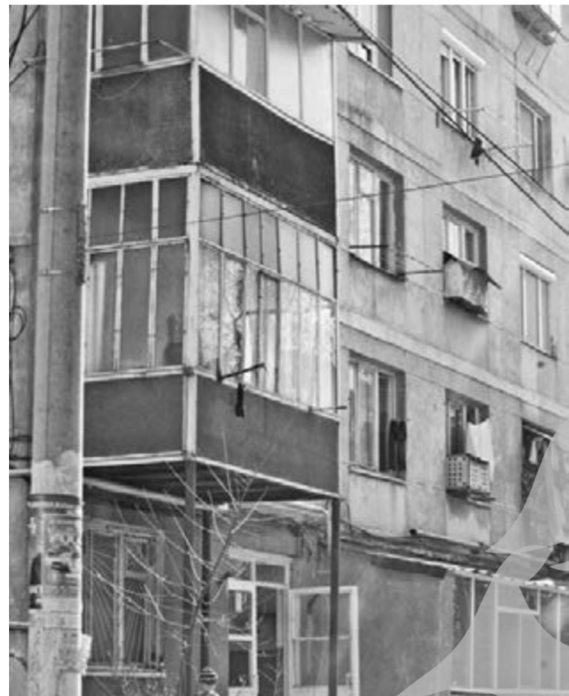
Piloni de metal, susținere (ne)sigură
