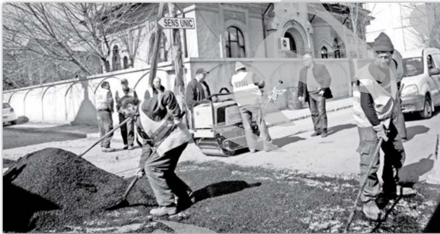
Gropile de pe Bălcescu au fost acoperite, însă nu chiar până la intersecția cu Brăilei...
