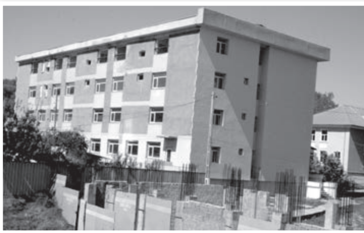
Lucrările de la campusul din Tg. Bujor se degradează pe zi ce trece
