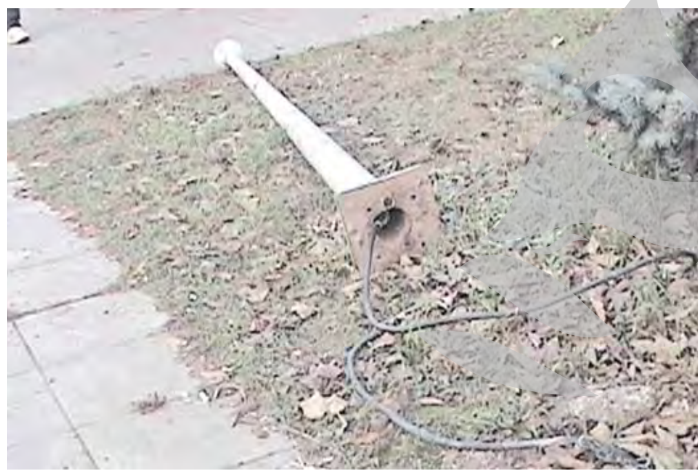
La Ultimul Leu, cabluri și stâlpi de iluminat la pământ - numai bine să-ți plimbi copilul prin parc
