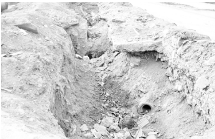
Șanțul lăsat neacoperit se umple încet cu mizerie
