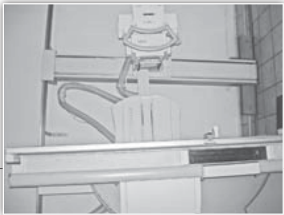
Aparatul de radiologie, după înlocuirea tubului
