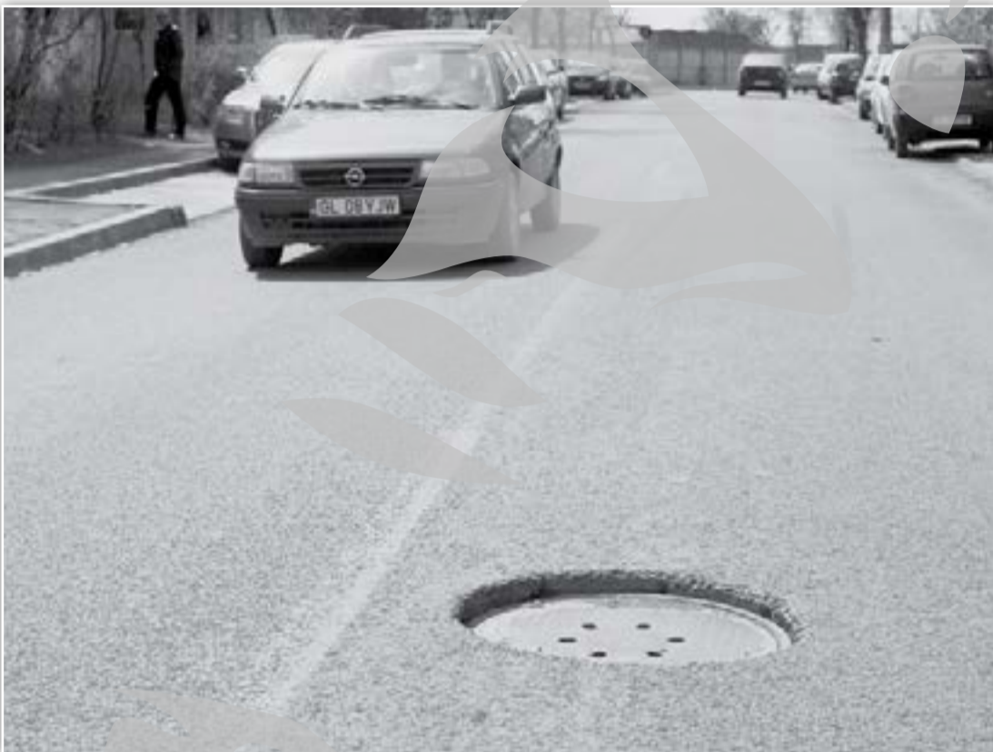
Capacele de canal sunt cu câțiva centimetri mai jos decât asfaltul
