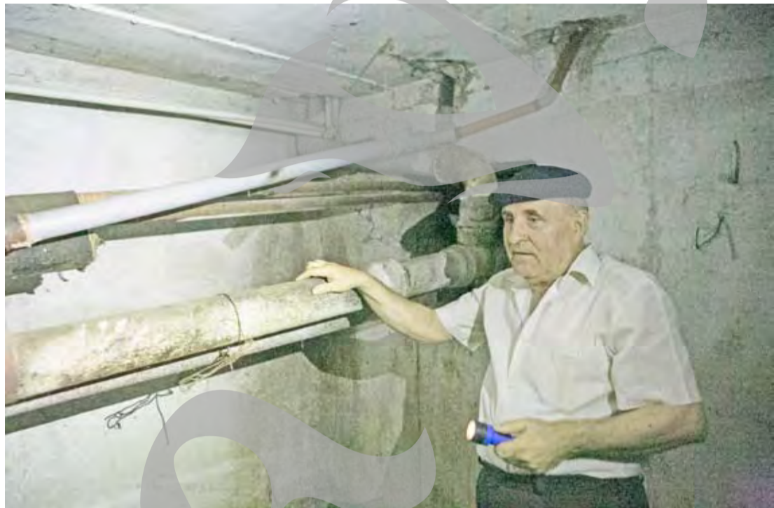
Locatarul Vasile Cătănoiu ne arată că blocul are bransament colectiv
