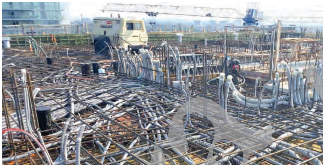
Așa arată o rețea electrică proiectată și executată de foreman Radu
