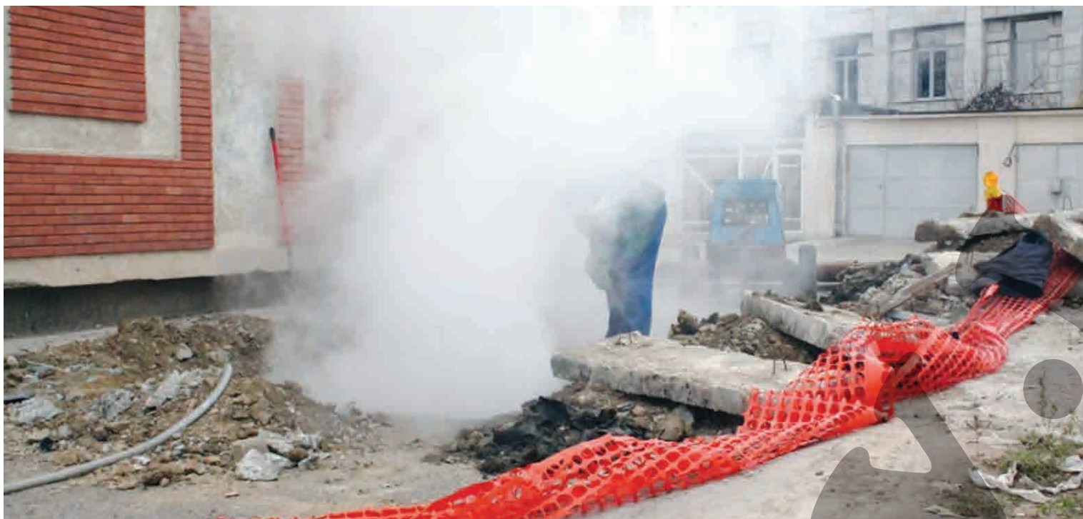
AVARIE LA O MAGISTRALĂ PRINCIPALĂ A CET ● DEFECȚIUNE
