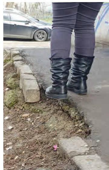
➤ Borduri lipsă, adrenalină maximă
