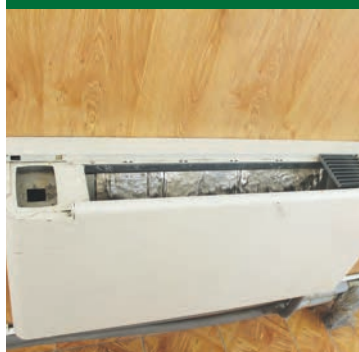
● Caloriferele pentru centrala geotermală stau de mobilier
