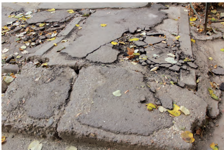
◆ Efectele tasărilor sunt vizibile și în zona blocului B8 foto Iulia Kelt
