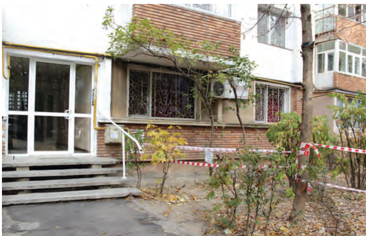
◆ Blocul are nevoie de lucrări de împrejmuire a imobilului și de semnalizare vizibilă foto Iulia Kelt
