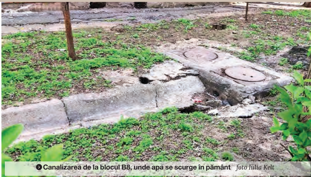
➤ Fisuri în spatele fostului dispensar medical din Țiglina III foto Iulia Kelt
