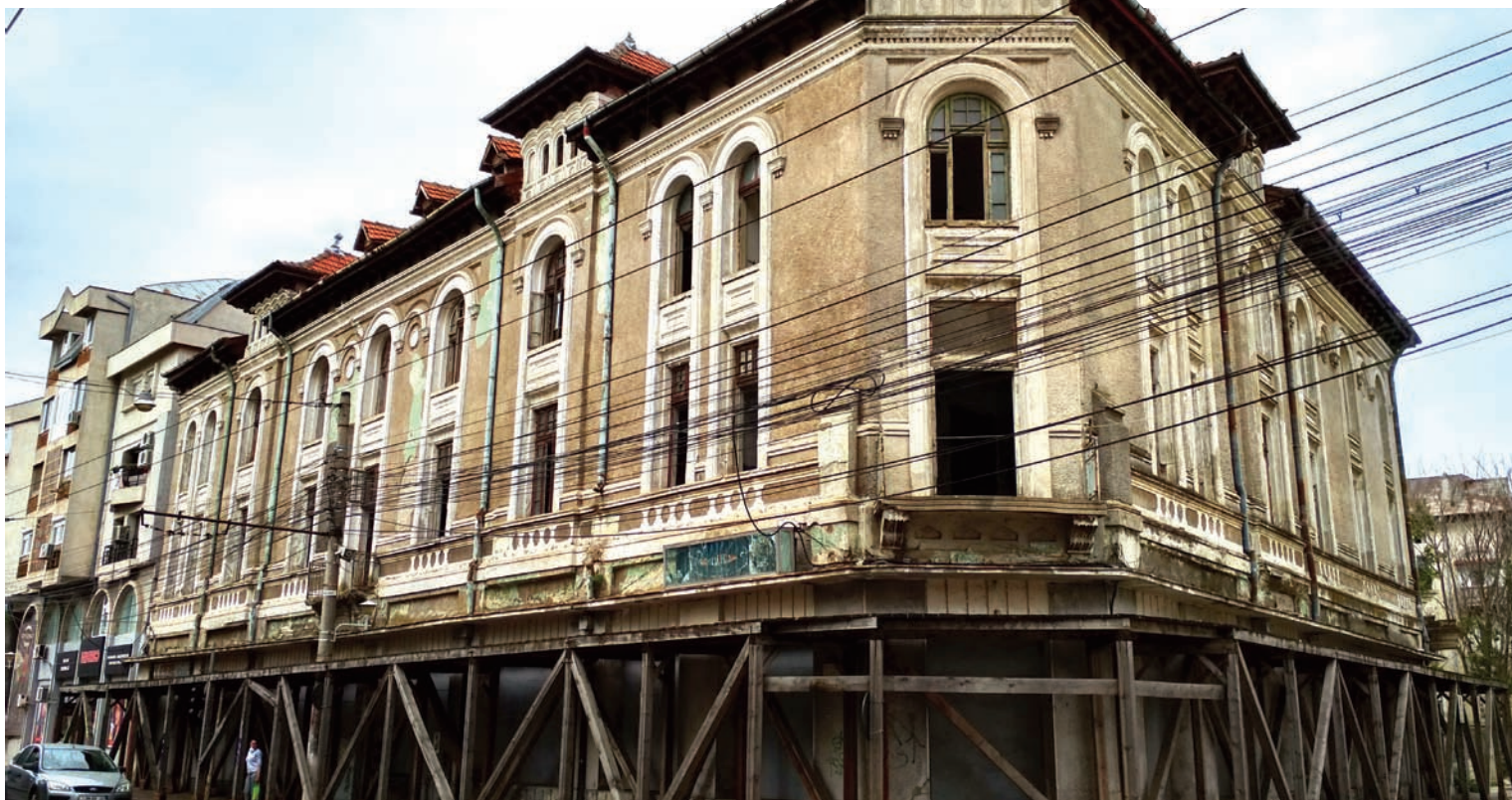
Clădirea se ruinează văzând cu ochii
